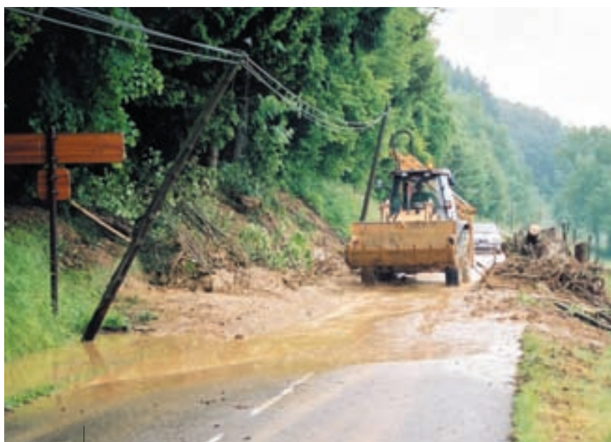
Coulée de boue - Merlas - phase post-urgence : rétablissement des voies de communication - juin 2002
